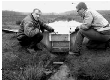
v.l: Vorarbeiter Wilfried Dohmes und Auszubildender Frank Petry vom Niersverband setzen die ersten Bretter ein. Fotos: Peter Kolshorn
